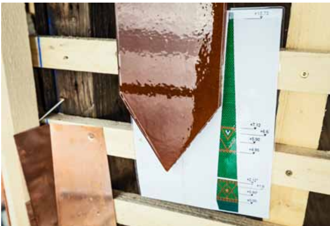
Bemusterung und Verlegeplan einer Teilfläche: Die neue Deckung mit verschiedenfarbigen Biberschwanzziegeln wurde exakt nach Plan verlegt.
