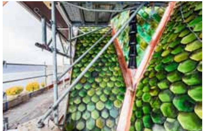
Die Entwässerungsebenen führte das Schmäh-Team in Kupfer aus.
