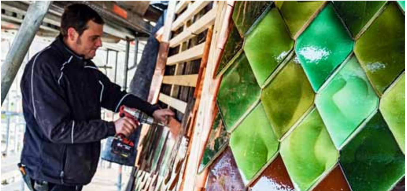
Fast senkrecht präsentieren sich die Dachflächen am Kirchturm in Sipplingen. Langzeitsicher wurden sämtliche Ziegel verschraubt.
