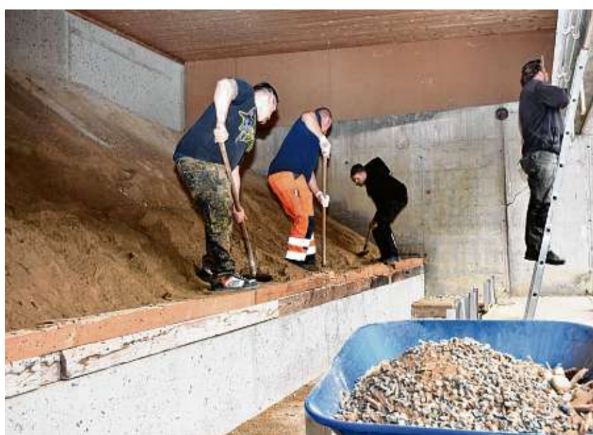
Die Daisendorfer Schützen richten ihre Anlage für den Sommerbetrieb her. Die Schießstände erhalten zusätzlich zu den Sandfängen bald teure Stahlkugelfänge. BILD: MARDIROS TAVIT
